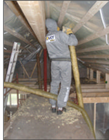
Ställning krävs vid fyllning underifrån.
