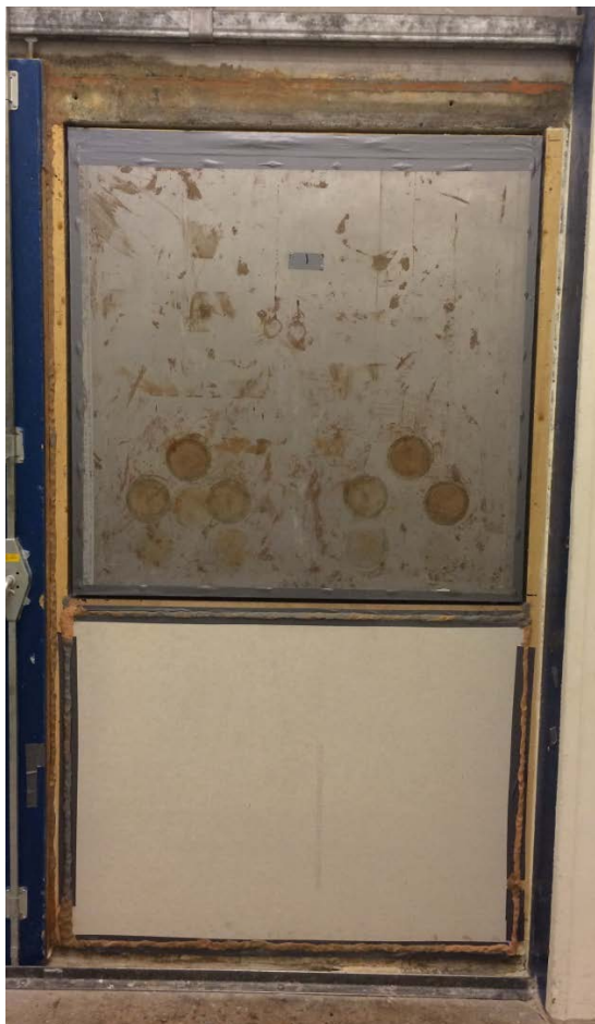
Bild 1 – Mottagarrummet (utsida), drevsystem 1. Tom fog.
